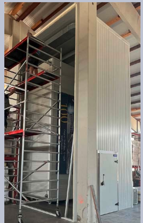
Klimabox in der Lagerhalle
